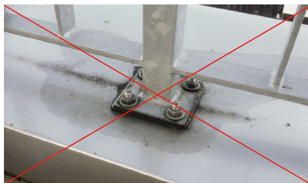
Abb. 7: Mangelhafte, unzulässige Ausführung.
